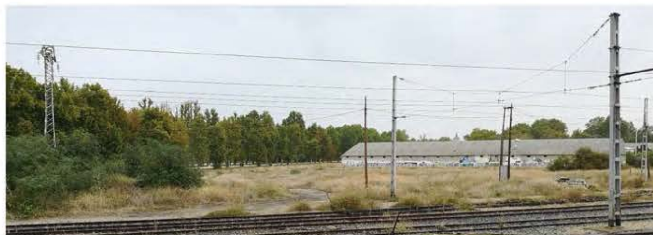
Red Eléctrica y Catenaria
