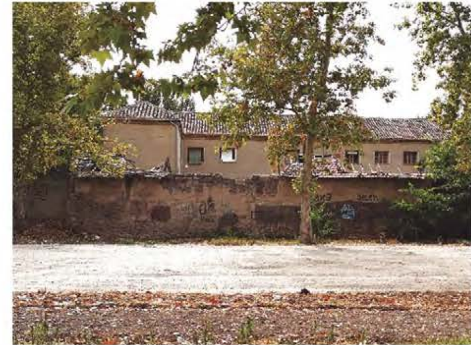
Ejemplo de edificación en estado de abandono.
